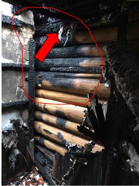
Рис. 1. Місце значного локального пошкодження горючих елементів парильного відділення сауни сухого жару (контур червоного кольору), обумовлений місцем інфільтрації кисню-повітря у приміщення через перекриття із послідовним утворенням «прогару» (стрілка червоного кольору)
